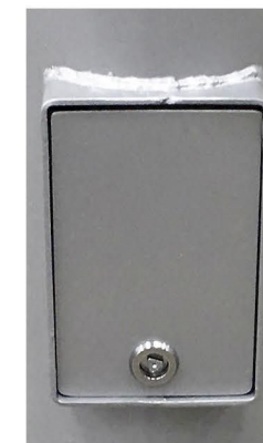
Detalle caja de conexiones
