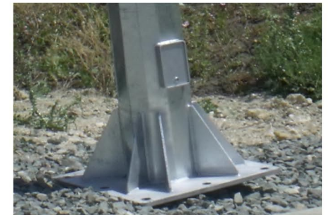
■ Detalle base mástil y caja de registro abisagrada.
